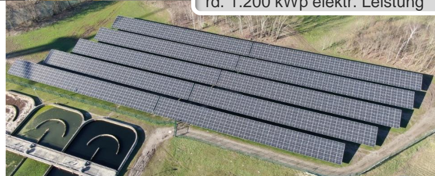
PV-Anlagen rd. 1.200 kWp elektr. Leistung
