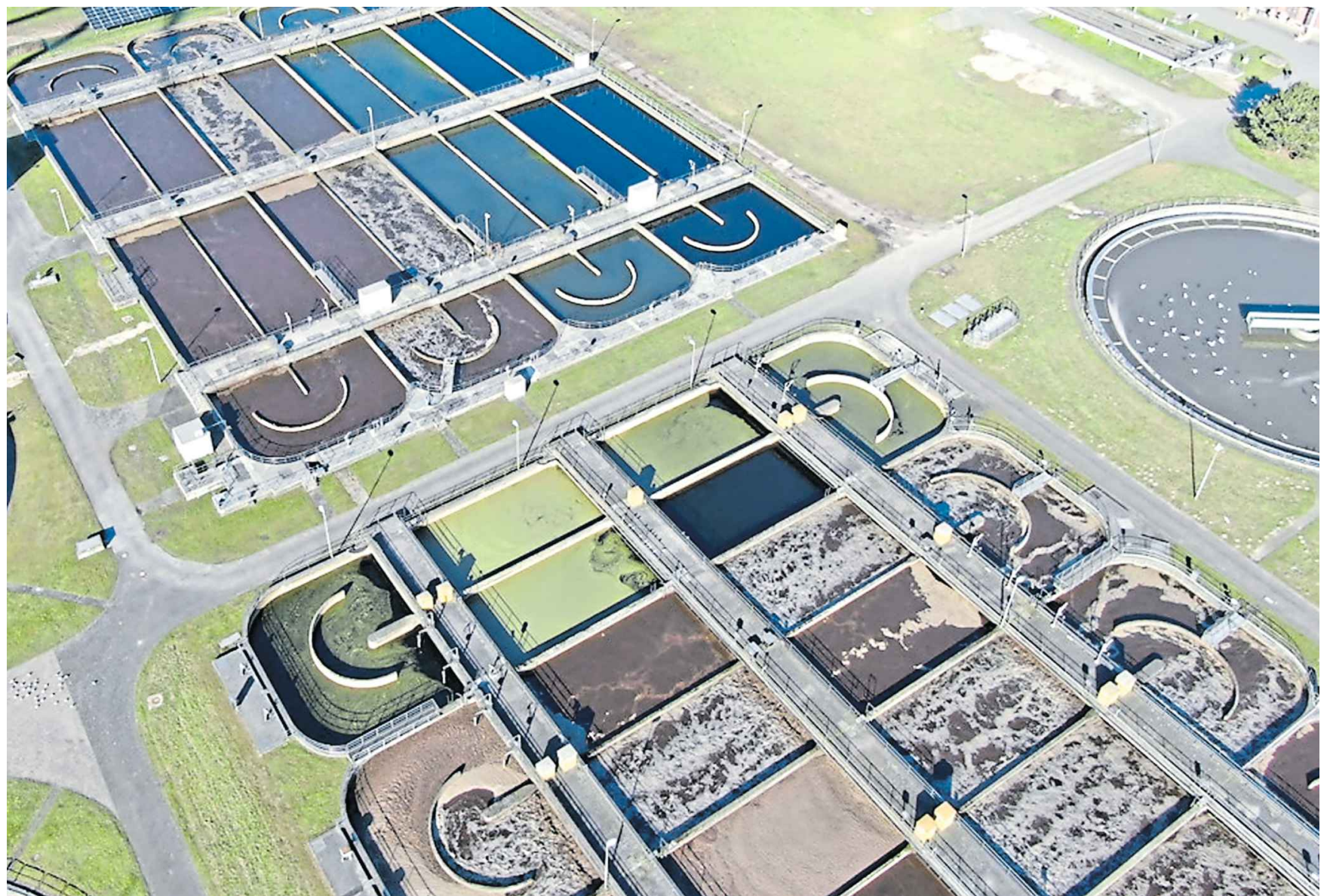
Das Abwasser aus der Stadt Paderborn wird in der Kläranlage gereinigt, bevor es in die Lippe eingeleitet wird. Hier ist die biologische Reinigungsstufe zu sehen. Foto: STEB
