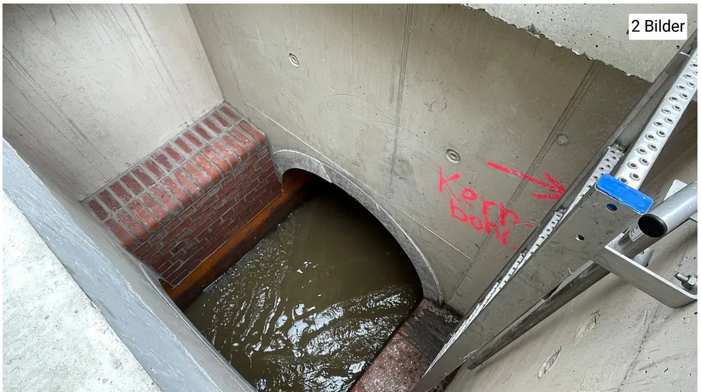
Der Abwasserhauptsammler im Bereich der Münsterstraße hat einen Durchmesser von 1,60 Metern. Im Normalstrom des Abwassers werden die Wärmetauscher installiert. Foto: Marc Schröder
